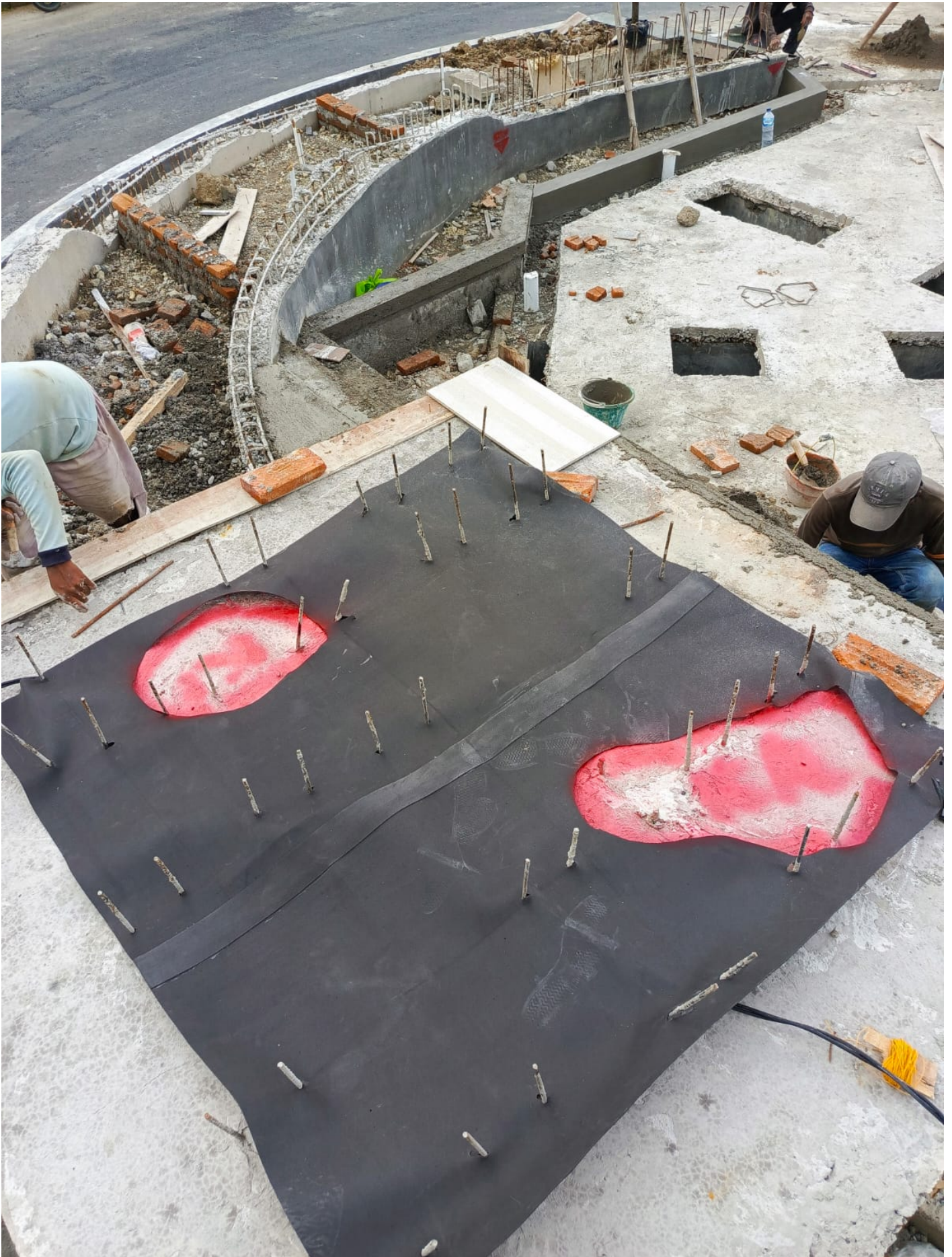
Mal posisi kaki di atas base beton.
